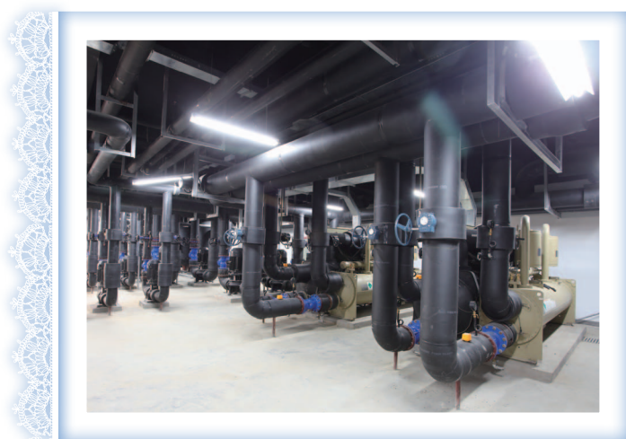
山東地源熱泵中央空調系統
